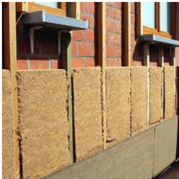
Niet-homogene isolatielaag: de muurisolatie is onderbroken door een houten structuur (Foto: Dialoog vzw)
