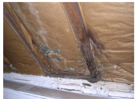
Isolatie: verkeerd geplaatst en in slechte staat (Foto: E. Willaert)
