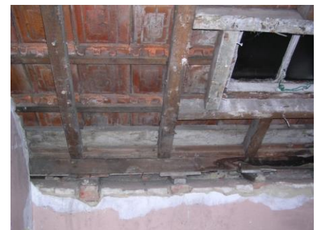
Houtwerk in slechte staat (Foto: E. Willaert)
