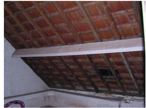
Hellend dak zonder onderdak (Foto: E. Willaert)
