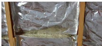
Verkeerde plaatsing van flensdekens (foto: Rockwool)
