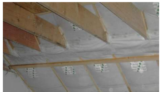
Spantendak: doorboringen van het luchtscherm ter hoogte van de trekbealken (Foto: E-advies)
