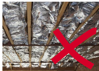
Zoldervloerisolatie met flensdekens: verkeerde plaatsing (foto: Shutterstock)
