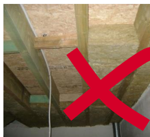
Vermijd leidingen tussen de isolatie (foto: arch. D. Van Clé)
