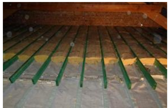
Luchtscherf, houten roostering en glaswolisolatie op de zoldervloer (foto: Isolteam)
