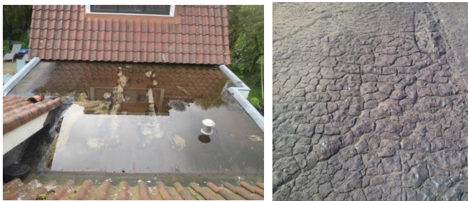
Plasvorming op een plat dak, verweerde dakafdichting
