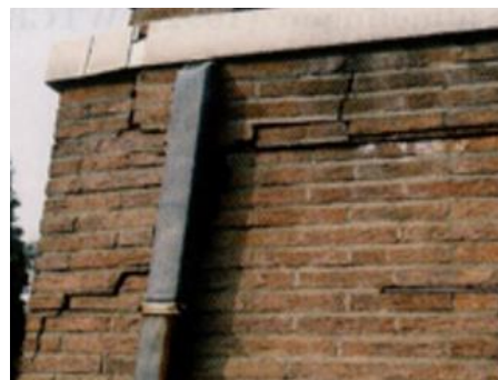
Scheurvorming in de muren bij massief plat dak met isolatie onder de draagstructuur, foto Dialoog vzw
