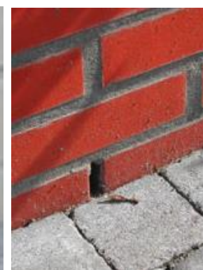
Te hoog geplaatste buitenverharding verhindert waterafvoer
