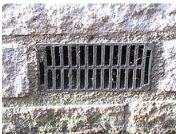
Verluchtingsrooster in spouwmuur, foto Wikipedia
