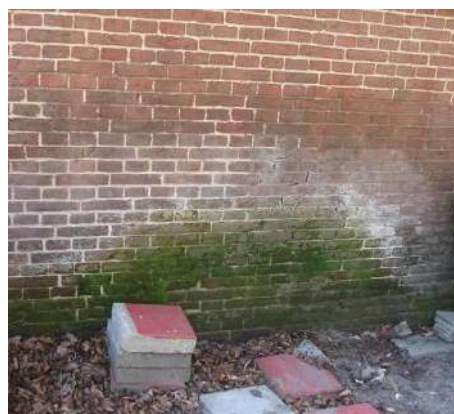
Gevel met mosgroei en zoutuitbloeiingen door spatwater, illustratie Monumentenwacht Gelderland
