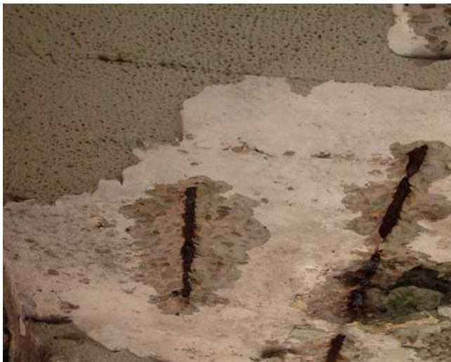
Kelderplafond met betonrot. (Foto: Group Rodinia)
