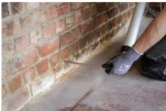
Injecteren van een muur tegen opstijgend vocht boven de vloerconstructie. (Foto: Buildwise)
