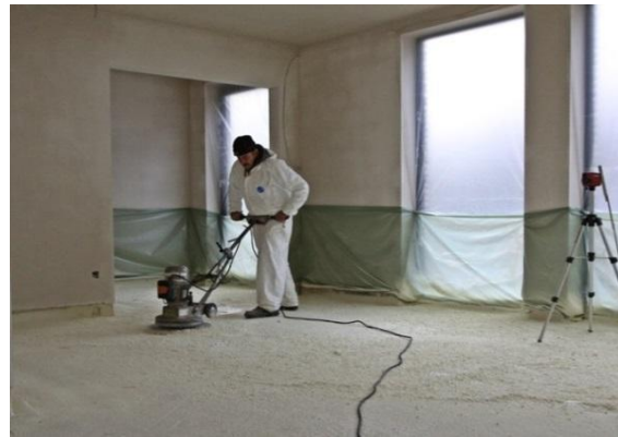
Opschuren van het uitgehard PUR schuim om tot een vlak oppervlak te komen. (Foto: Isofloor)
