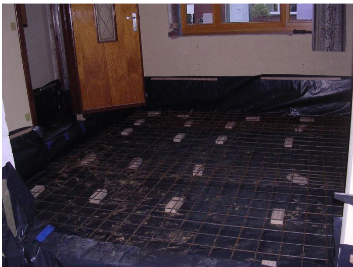
Plaatsing van een PE-folie als vochtmembraan, tegen de muren omhoog geplooid tot boven de waterkerende laag. (Foto: Evelien Willaert)
