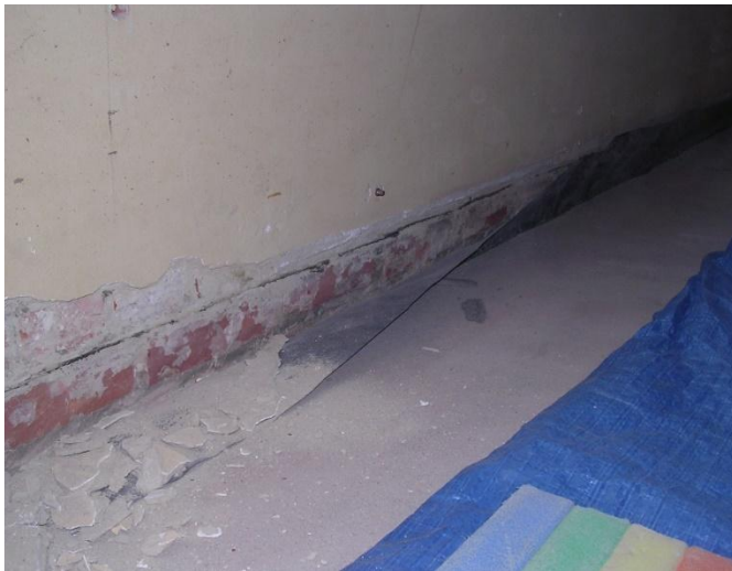
Omhoog plooiën van het vochtmembraan tot boven het niveau van de waterkerende laag in de muur. (Foto: Evelien Willaert)
