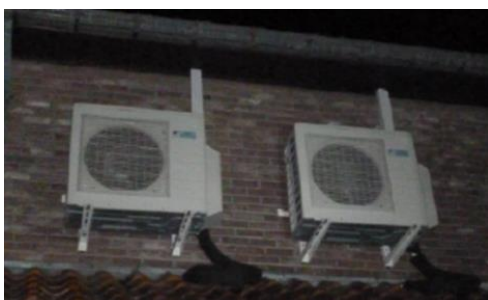
Buitenunits van splittoestellen, bron Dominic Van Clé.
